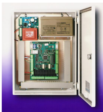
CENTRALE DE CONTRÔLE D'ACCÈS
